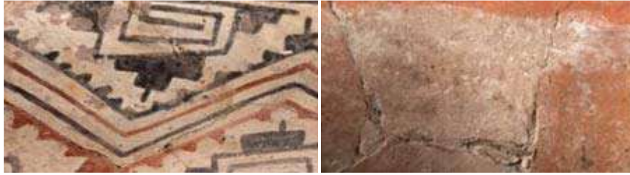
(Fig. 10). Resanes identificados, Pre-intervención (Rivas 2012)
