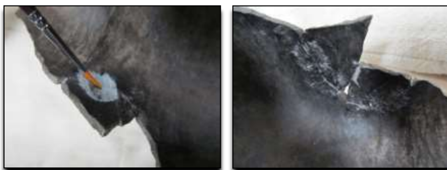
Refuerzos estructurales (de la Calle, 2014)
