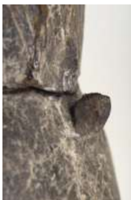
Faltantes (estructurales) (Rivas, 2014)
