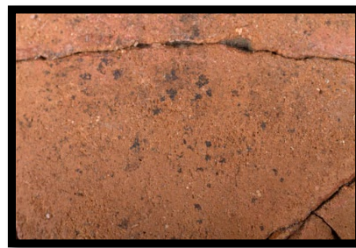
Figura 51 a. Vista general y detalle del efecto pedestal Pre-intervención (LAD456. y LAD456.30) (Fotografías a y b: V. Rivas, 2016. Archivo CNCR).
