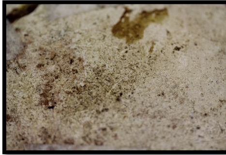
Figura 38 a. Detalle de la erosión en el exterior de la base Pre- intervención (Fotografías a: V. Cancec, 2016).
