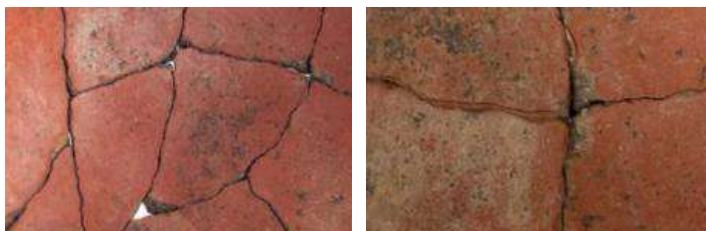
(Fig. 17).Manchas, Pre-intervención (Rivas 2012)
