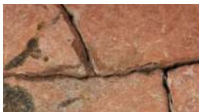
(Fig. 12).Efecto pedestal, Pre-intervención (Rivas 2012)
