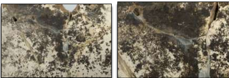
Exceso de adhesivo en uniones y superficie, Pre-intervención (Rivas 2012)
