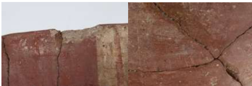
(Fig. 15). Faltantes (superficiales) (Rivas, 2012)
