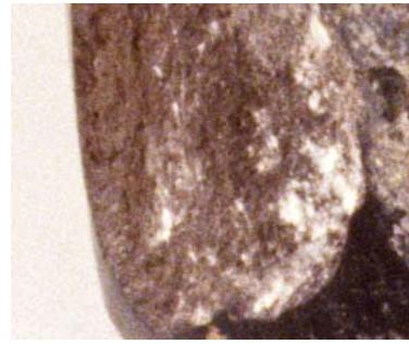
Exfoliación producida por el deplacamiento.
