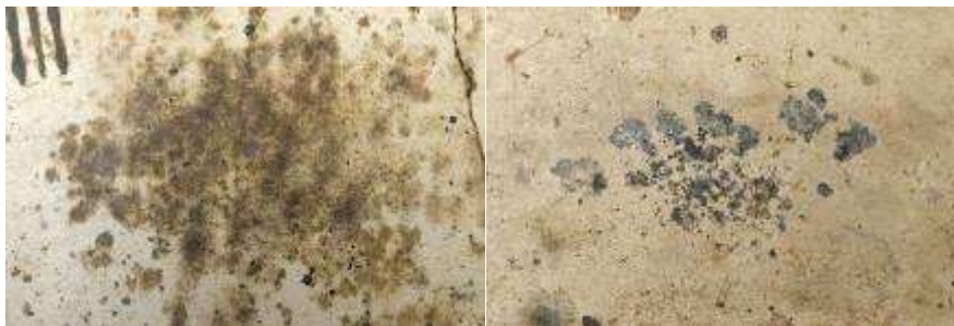
(Fig. 19). Adherencias, Pre-intervención (Rivas, 2013)
