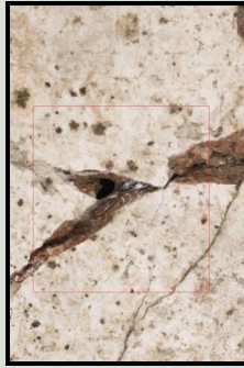
Exceso de adhesivo en la base (Rivas 2011)
