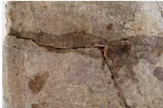
Exceso de adhesivo
