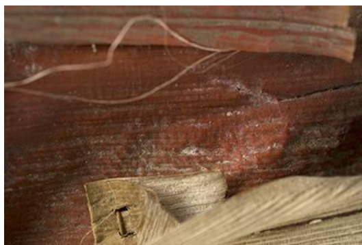
Imagen nº 29: Detalle de eflorescencia salina.
