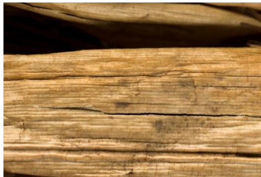
Imagen nº 22: Detalle de grieta.
