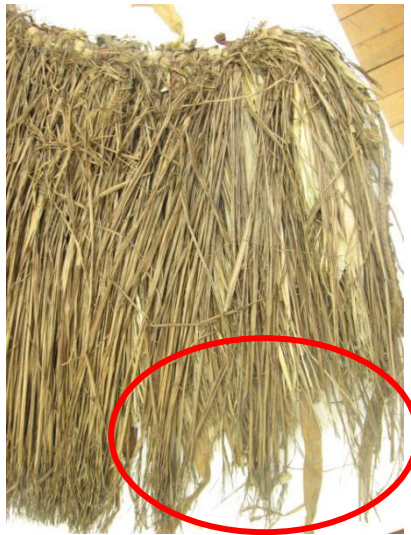
Imagen nº 16: Área de faltante de junquillo
