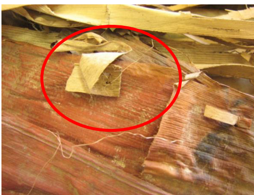
Imagen nº 25: Detalle de faltante de pieza que compone el damero, quedando solamente un fragmento
