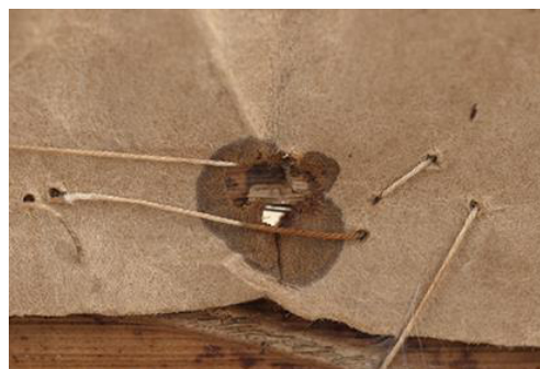
Imagen nº 17: Detalle de orificio con mancha alrededor.
