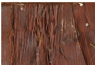
Imagen nº 21: Detalle de grietas en cara 2 de la falda.
