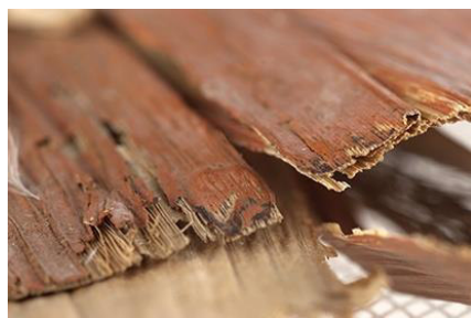
Imagen nº 34: Detalle de delaminación. Si bien se observa también la pérdida de capa pictórica, esta alteración se ha establecido como delaminación ya que se ha perdido la capa superficial de la placa de fibra vegetal.
