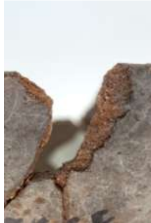
Detalle faltante en el borde. (Rivas, 2013)
