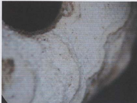
Detalle de perdida por Friabilidad
