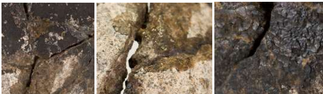
Excesos de adhesivos. (Rivas, 2014).
