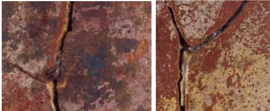
Excesos de adhesivos (Rivas, 2014).
